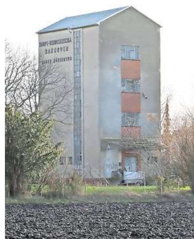
Das Silo hat unter anderem ein neues Dach erhalten. FOTO: WERNER KAISER
